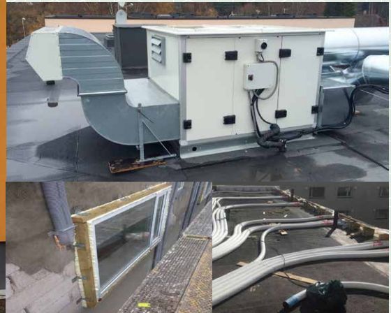
Kuva 2. Virolaisissa kerrostaloissa yleistyvä korjausratkaisu, jossa ilmanvaihto lämmöntalteenotolla järjestetään asentamalla litteät tuloilmakanavat julkisivuun lämmöneristekerrokseen.
