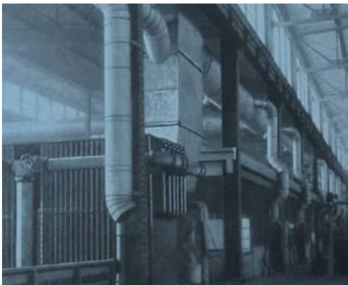
Kuvassa vuodelta 1920 on oikeaoppista lämmitetyn ilman jako eli puhallus alas. Isojakin koneita sijoitettiin tuotantotilaan, kun äänitaso osastoilla oli muutoinkin korkea. (Am)
